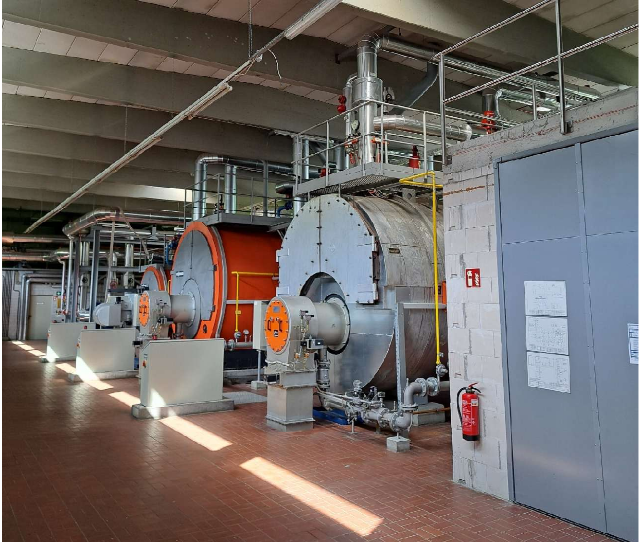
Abbildung 3: Blick in das Heizwerk (von rechts nach links: BHKW, Kessel 3, Kessel 2, Kessel 1), Eigene Aufnahme 2025
